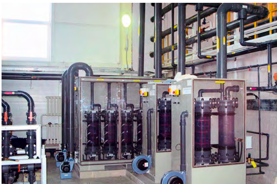
Фото компании Grundfos
