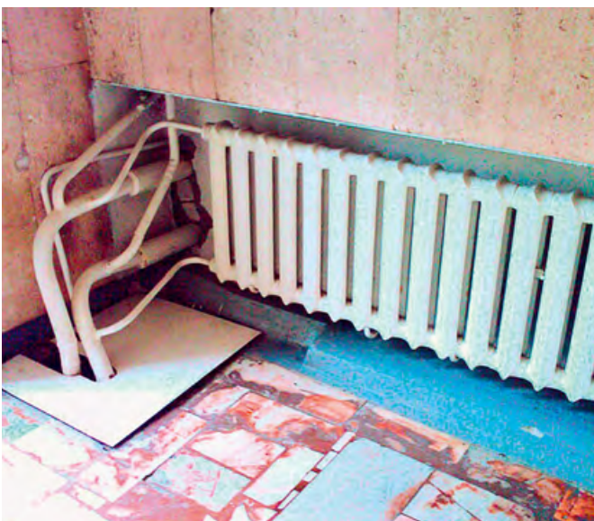
Рис. 8. Пример «похмельной» обвязки радиатора
