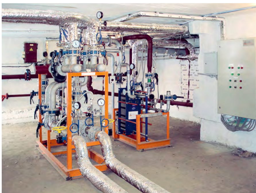
❖ Фото 1. Индивидуальный тепловой пункт
