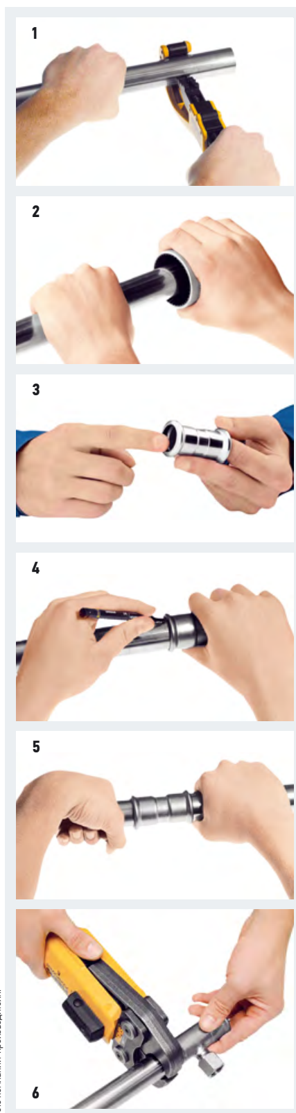
⚡ Рис. 1. Соединения: чисто и просто! (1 — резка трубы; 2 — снятие фаски с торца трубы; 3 — смазка прокладочного элемента; 4 — отметка глубины вставки трубы; 5 — монтаж трубы и соединителя; 6 — опрессовка)
