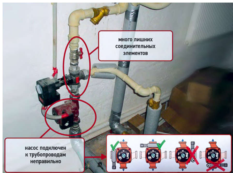
❖ Рис. 1а. Пример стандартного узла монтажа — громоздкий, неудобный, имеющий ошибки и внешне эстетически непривлекательный (много лишних соединительных элементов, насос подключен к трубопроводам неправильно)
