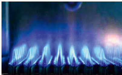
❖ Горелка котла EMF
