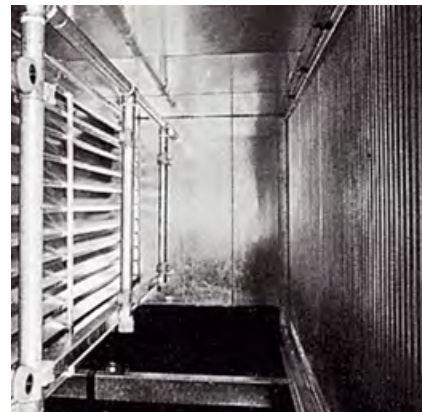
■ Рис. 14. Секция увлажнения
