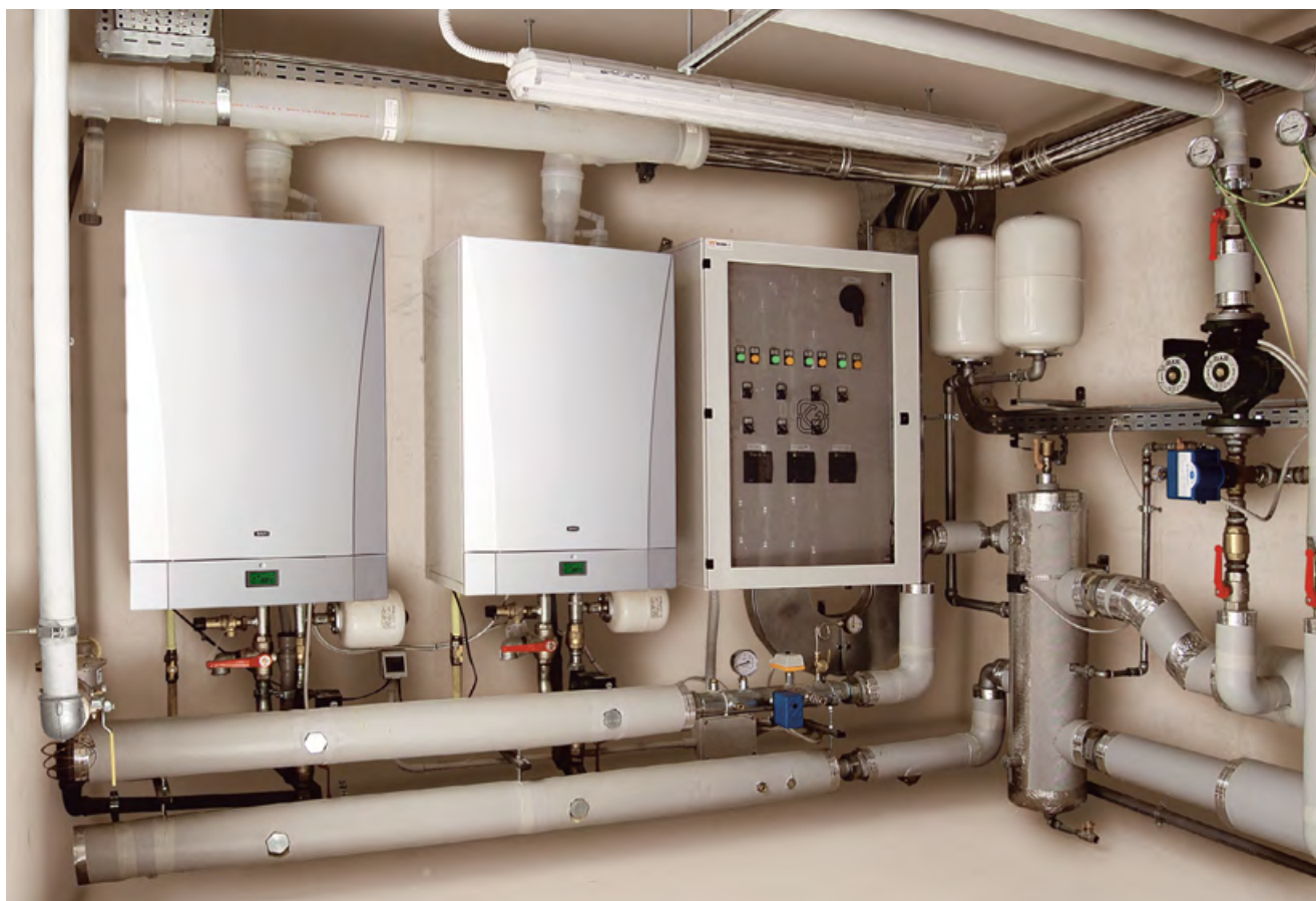
Рис. 10. Пример гидравлического разделителя, используемого вместе с каскадом из настенных конденсационных котлов BAXI
