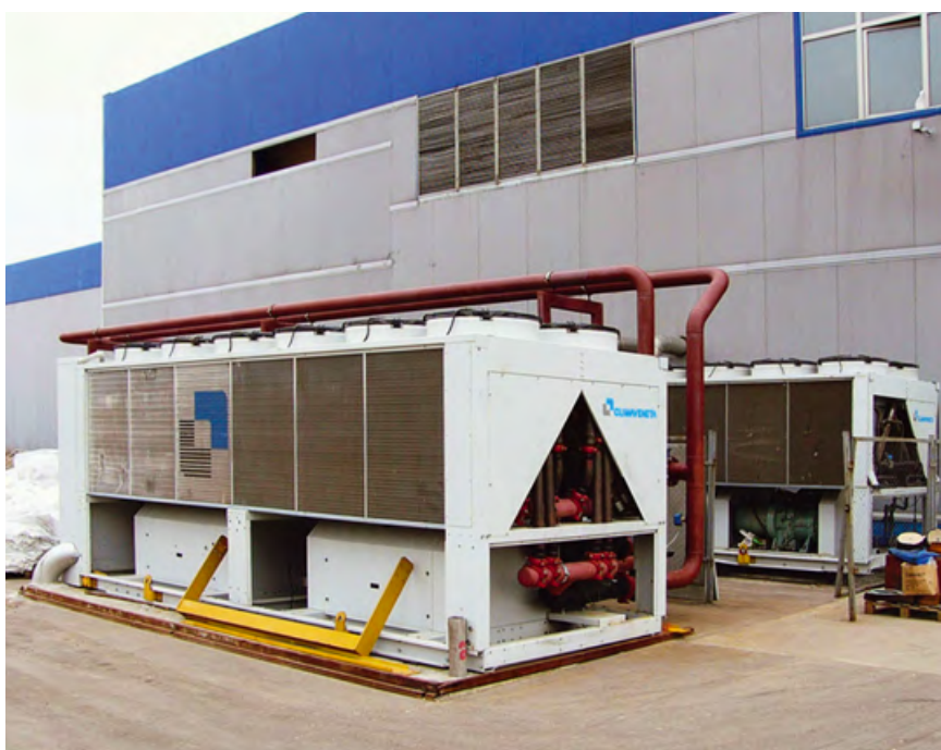
■ Холодильные машины с естественным охлаждением на заводе «Нидан-Гросс» (Московская обл.)
