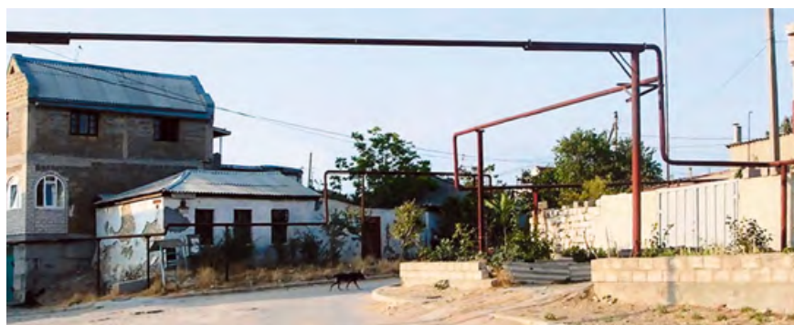
■ Газопровод, открыто проложенный по ул. Крейцера в Севастополе
