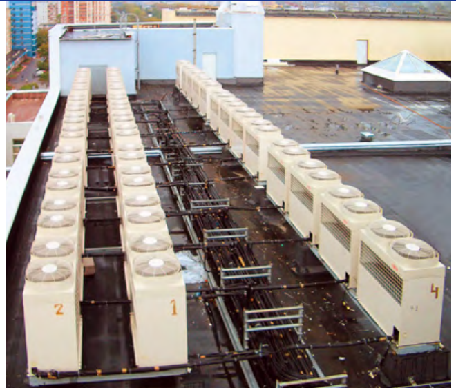
■ Наружные блоки, установленные на кровле здания торгового центра
