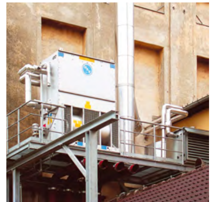
■ Градирия и забор наружного воздуха на охлаждение корпуса микрогазотурбины
