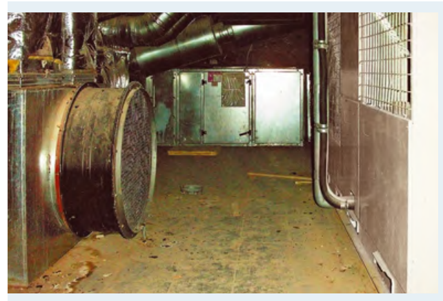
Рис. 3. Приточный вентилятор с термостатом
