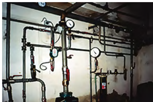
■ Фото 2. Теплообменник ТТАИ в качестве скоростного бойлера ГВС пятиэтажного офисного здания
