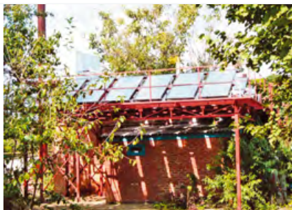
Рис. 1. Гелиоустановка котельной в станции Анастасиевской
