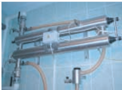
Установка «ЛИТ» УДВ-10
