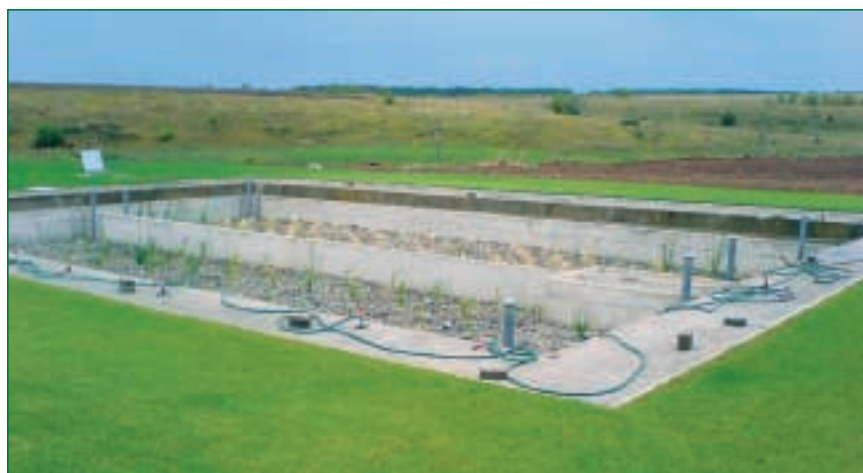
Введение в эксплуатацию ЗБГТ
