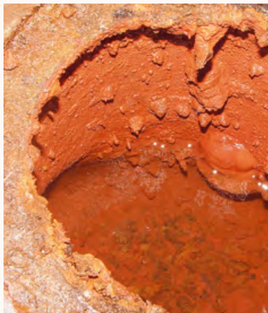
Рис. 2. Биокоррозия в водопроводных сетях
