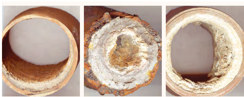
Рис. 1. Внешний вид трубопроводов распределительных сетей
