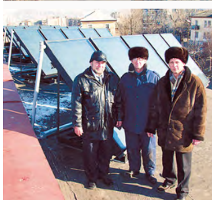
Рис. 7. Солнечная водонагревательная установка для горячего водоснабжения
