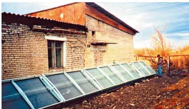
Рис. 5. Солнечная водонагревательная установка с солнечным коллектором трубчатого типа
