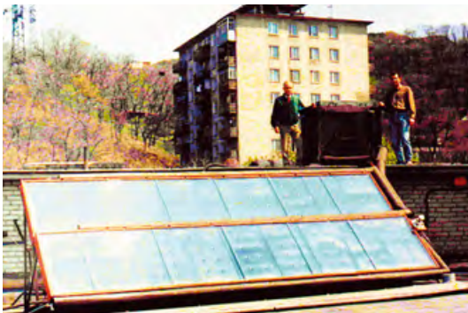
■ Рис. 3. Солнечная водонагревательная установка в г. Партизанске
