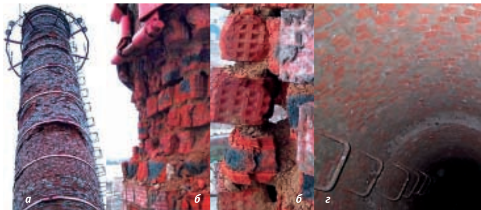
Рис. 1. Повреждения кирпичной дымовой трубы (топливо — газ) (а — эрозионные повреждения с разрушением кирпича лещадками; б — разрушение кирпича на отметке 15 м; в — разрушение раствора швов; г — внутренняя поверхность ствола трубы)
