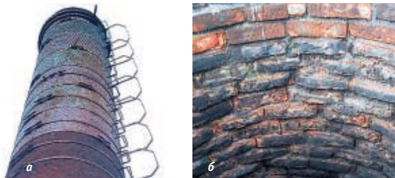
Рис. 4. Повреждения кирпичной дымовой трубы (топливо — мазут) (а — кирпичная кладка и раствор в швах не имеют глубоких эрозийных повреждений, марка кирпича соответствует проектной; б — марка кирпича футеровки не соответствует проектной, снижение прочности кирпичной кладки футеровки произошло по причине химической коррозии)
