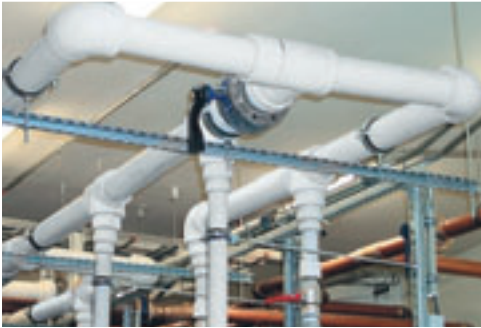
Системы водоочистки и подготовки горячей воды гостиничного комплекса River Side Swisshotel
