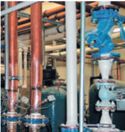
Станция повышения давления
