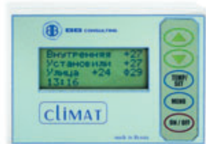
Пульт управления установкой «Климат»
