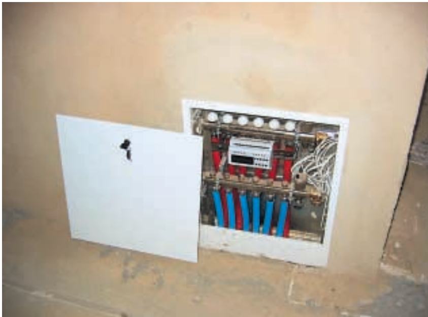
Рис. 3. Установка контроллера непосредственно в коллекторный ящик
