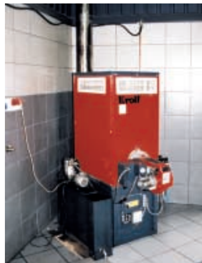
Стационарный теплогенератор KROLL 55S
