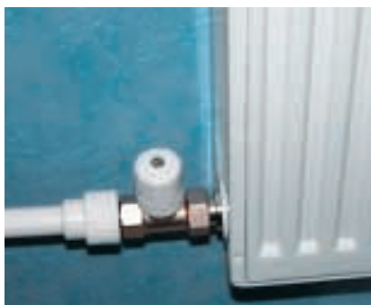
Нижнее боковое подключение радиаторов к отопительной системе
