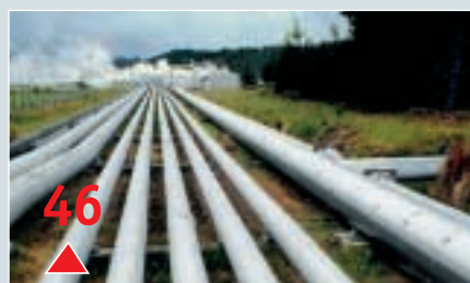
О диагностике состояния систем отопления потребителей тепловой энергии
