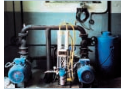
Рис. 4б. Система подготовки воды из поверхностного источника для подпитки контура охлаждения компрессоров производительностью 0,2 м 3 /ч (ОАО «Щуровский цемент», г. Коломна)
