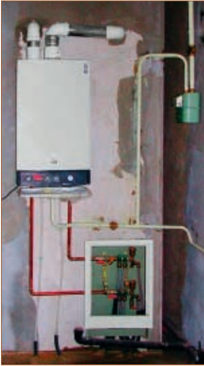
Котел Lupa Baxi в жилом доме, г. Уфа.
