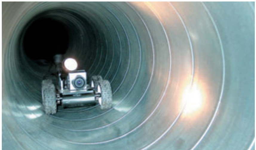
Инспекционный робот проводит обследование воздуховода
