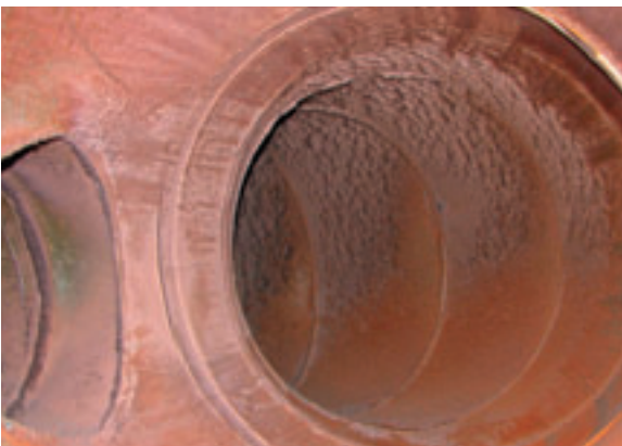
Отложения пыли в воздуховоде системы вентиляции
