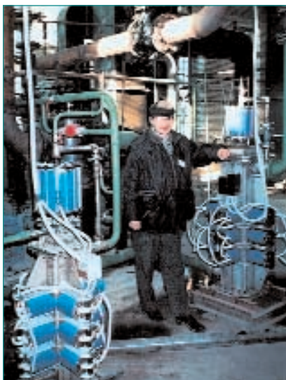
Ленинградская область, г. Фornosово, ЗАО «МНПП «ФАРТ», новая котельная. 2 аппарата УПОВС «Макмир» производительностью 5 м³/ч и 30 м³/ч
