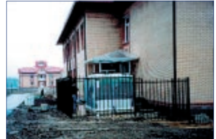
Рис 4. Размещение низкошумящей версии водоохлаждающей установки на территории, прилегающей к учебному корпусу
