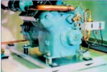
Рис 2. Компрессор, установленный на виброосновании
