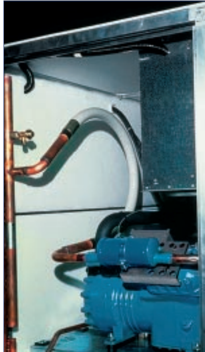
Рис 3. Компрессор, оснащенный глушителем и вибровставками на всасывающем и нагнетательном трубопроводах
