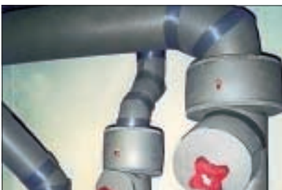
Правильный монтаж с одной ошибкой: отсутствует армированная лента на стыках
