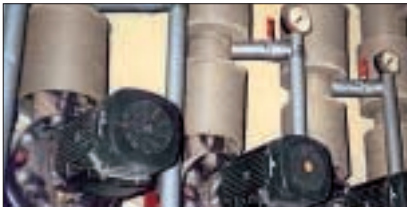
Распространенная ошибка. Отсутствие изоляции на компрессорах не означает отсутствия изоляции на месте соединения с трубой
