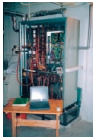
Компрессорно-конденсаторный агрегат, установленный в частном коттедже, г.Казань
