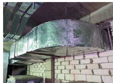
Рис. 3. Прокладка инженерных коммуникаций (установка перфорированных кабельных лотков), способствующая загрязнению поверхностей воздуховодов
