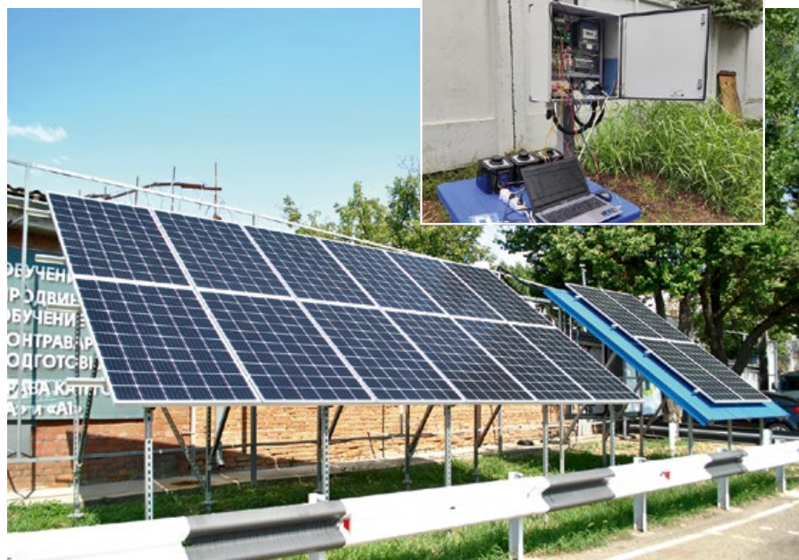
■ Солнечная электростанция 5 кВт на полигоне УДПО «Энергетический институт повышения квалификации» ПАО «Кубаньэнерго» (город Краснодар) и испытания опытного образца контроллера присоединения объектов микрогенерации на том же полигоне (на врезке сверху)
