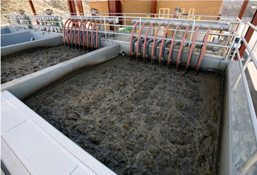
•• Здоровый активный ил в иловой камере очистных сооружений
