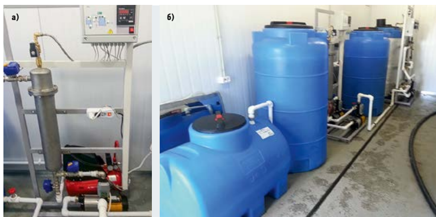
Рис. 5. Установка на станции Пыталово производительностью 4 м 3 /ч с блоком фильтрования (а) и блоком фильтрования промывных вод (б)
