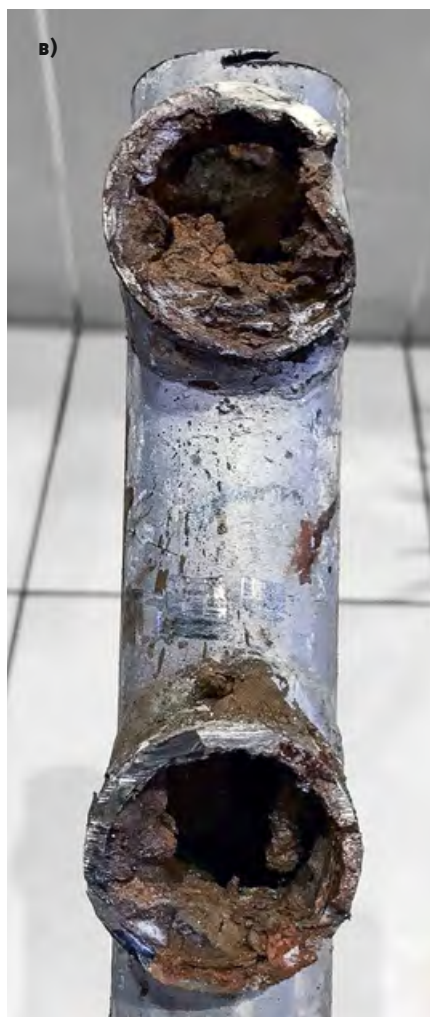
Рис. 4б–г. Вырезанные участки трубы из стояка ГВС со следами интенсивной коррозии
