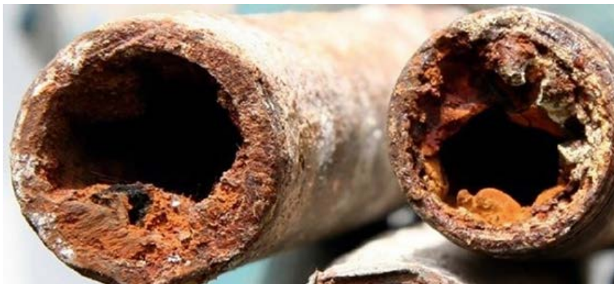
Рис. 1. Внутренняя коррозия водопроводных труб
