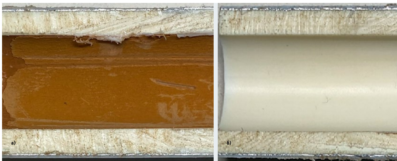
:: Фото 2. Фрагмент полипропиленовой трубы после 16 лет эксплуатации в системе горячего водоснабжения МКД в Санкт-Петербурге (а — оригинальный вид состояния фрагмента полипропиленовой трубы, б — отмытый от отложений фрагмент той же полипропиленовой трубы)
