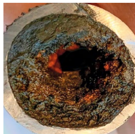
:: Фото 3. Комплексные отложения коррозионно-минеральных компонентов в стальной оцинкованной трубе системы холодного водоснабжения многоквартирного дома в СПб
