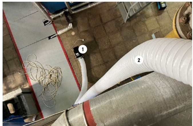
Фото 3. Фотография с места установки вентилятора в рабочую зону в помещении котельной, в которой изначально наблюдались высокие значения температуры воздуха (нижняя рабочая зона: 1 — центробежный вентилятор; 2 — полимерный воздухопровод длиной 8 м)
