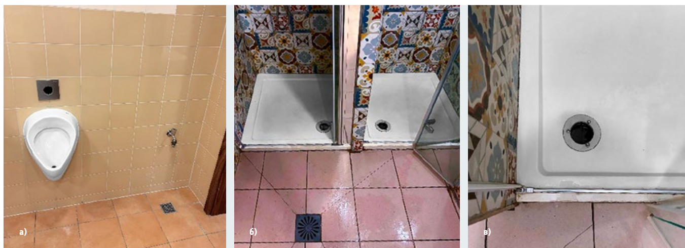
❖ Фото 4. Сантехнические устройства в Польше: напольный слив в ванной комнате с правильно установленным гидрозатвором, предотвращающим выход канализационного газа (а); душевая комната в хостеле New World в Варшаве с отсутствующими вставками гидрозатвора и открытыми канализационными трубами (б); увеличенный фрагмент изображения (б), на котором чётко видно отсутствие вставки гидрозатвора (в)
