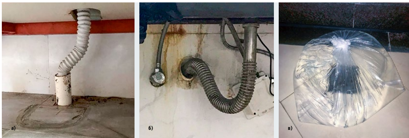
:: Фото 1. Соединения сливов раковин без надлежащего уплотнения в Китае: негерметичное соединение слива раковины с канализационной трубой и отсутствие гидрозатвора (а); канализационная труба раковины без надлежащей герметизации (б); пластиковый пакет с водой для предотвращения выхода канализационных газов из напольного слива без гидрозатвора в гостиничном номере в КНР (в)
