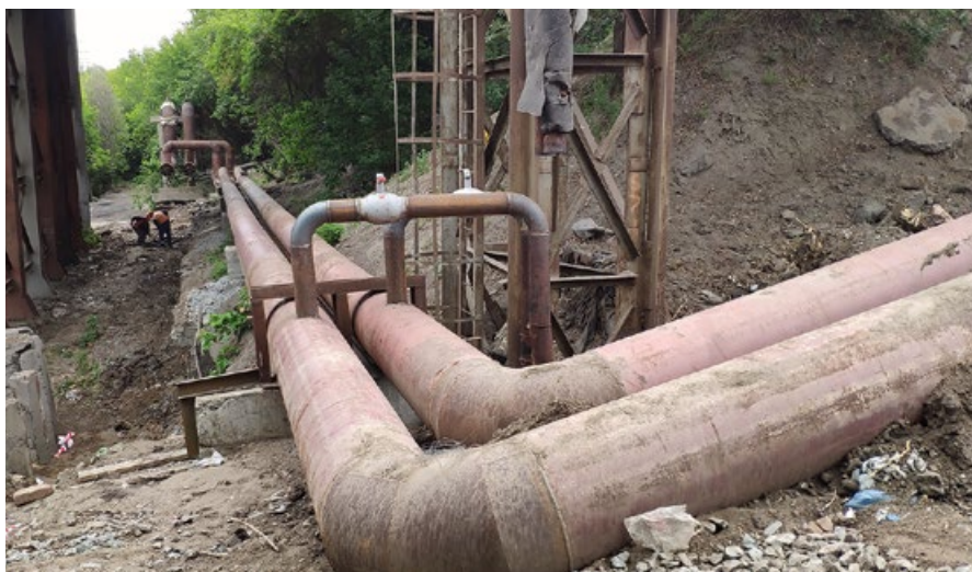
• • Фото 3. Исполнение запорной арматуры на врезке в трубопровод участка магистральной тепловой городской сети
