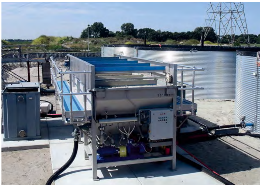
Установка кондиционирования воды (80 м³/ч) методом компрессионной флотации
