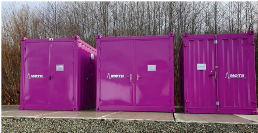
❖ Фото 1. Оборудование для стенда энергоснабжения лагеря МЧС
