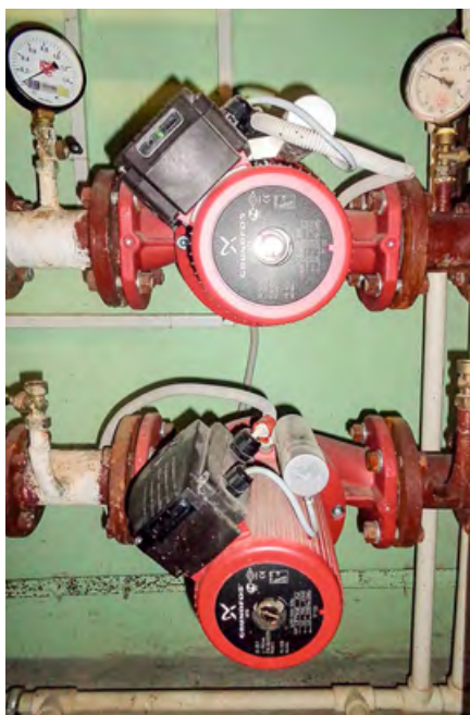
❖ Фото 1. Насосная группа на тепловом пункте существующего потребителя, выполненная из насосов Grundfos типа UPS с частотно-регулируемым приводом (ЧРП)
