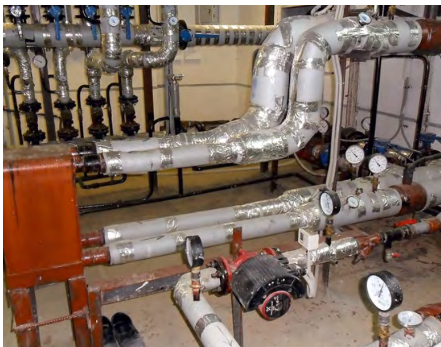
❖ Фото 2. Пример подключения моноблочного теплообменного аппарата к распределительному коллектору (на заднем плане)
