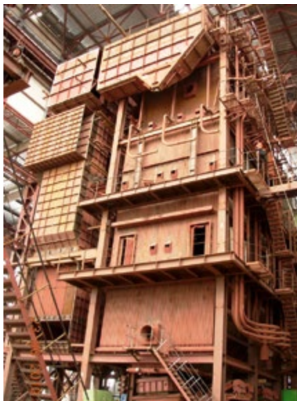
❖ Паровые котлоагрегаты, используемые на ТЭЦ, представляют собой массивную конструкцию высотой более 33 м
