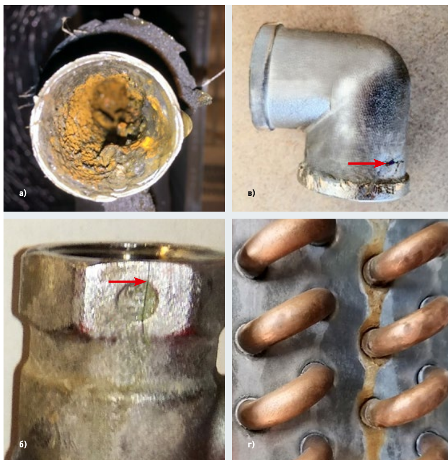
Рис. 1. Типовые разрушения элементов систем водоснабжения, отопления и кондиционирования (а — отложения, б — растрескивание, в — язвенная коррозия, г — контактная коррозия)
