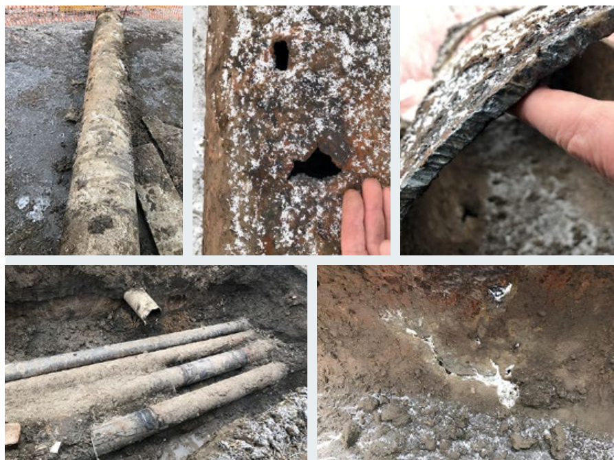
Рис. 7. Характерные признаки дефектов магистральных трубопроводов
