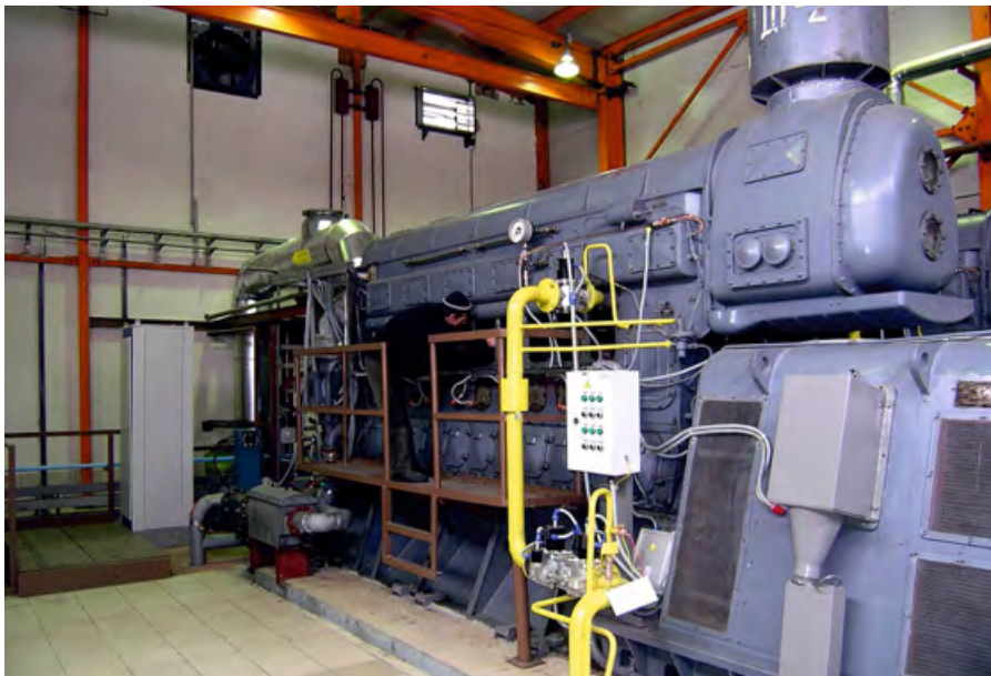
Рис. 2. Газопоршневая электростанция 11ГД100 мощностью 1000 кВт на Валуйском комбинате растительных масел (Белгородская область)
