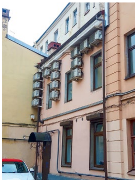
❖ Фото 2. Размещение наружных блоков кондиционеров на фасадах исторических зданий
