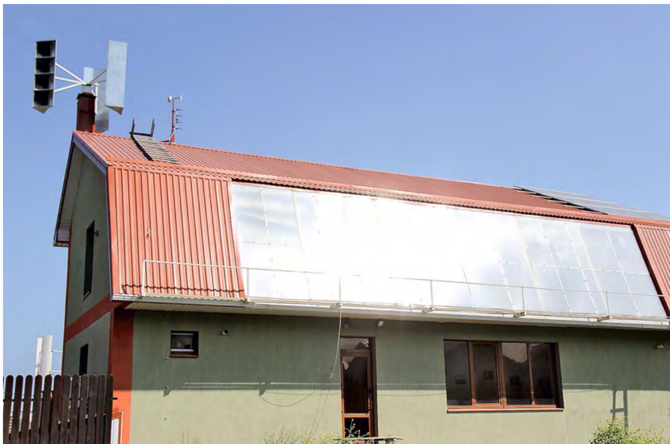
●● Фото 1. Гибридный солнечный коллектор, смонтированный на крыше
