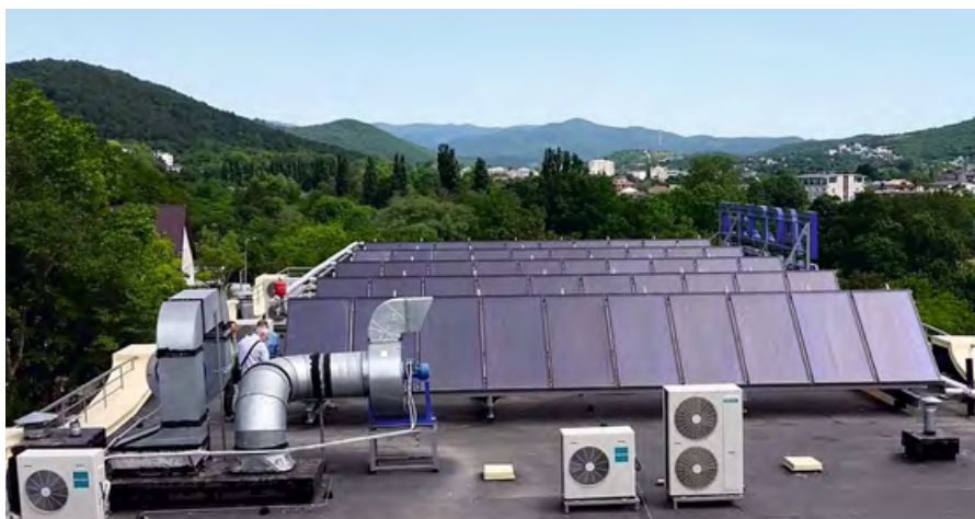
... Фото 2. Гелиоустановка в посёлке Архипо-Осиповка (Краснодарский край)
