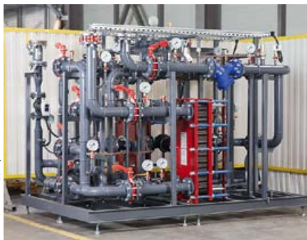
... Фото 1. Блок независимого подключения системы отопления/вентиляции в БТП
